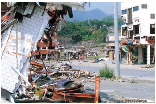
大槌町の市内にはまだこの様な建物が残されており、全ての解体が終了するのはいつのことか
