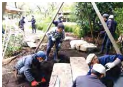
木曽大板の踏石や甲州鞍馬の石橋を三叉を用いての据え付け
